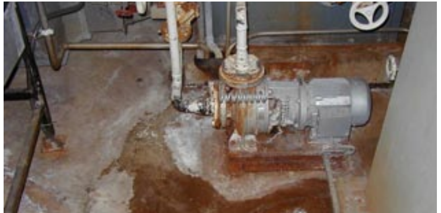
Sanierungsbedürftige Klima-Zentrale im Institut für Grundwasserökologie
